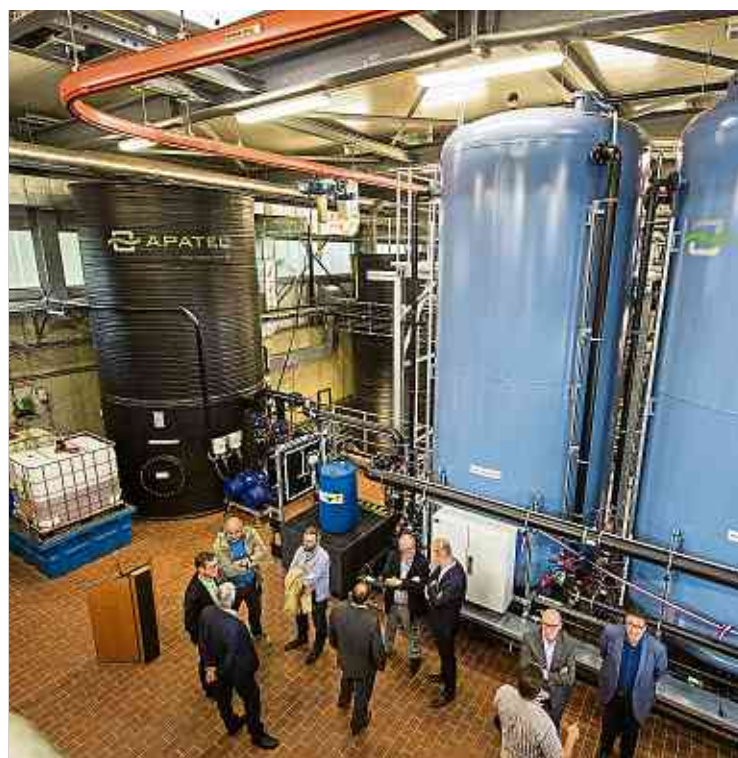
Herz der Anlage sind die blauen Tanks mit Aktivkohle. Jeder von ihnen fasst 20 Kubikmeter.
